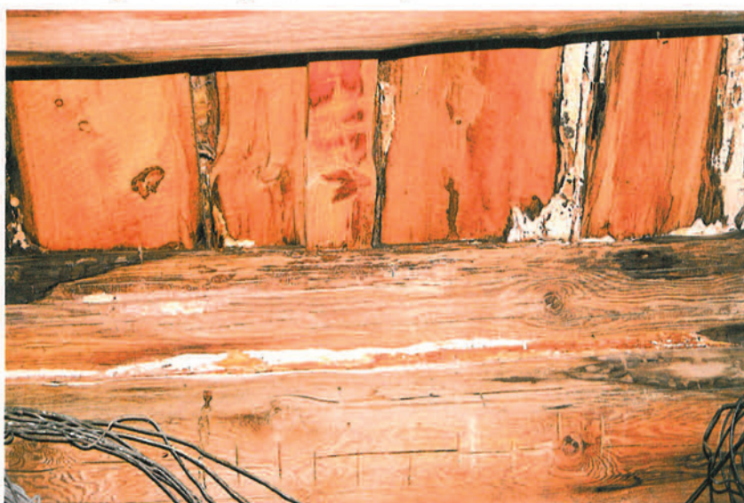
Barksopp. Tynne, hvite fruktlegemer i takbord under torvtak med lekkasjer.
