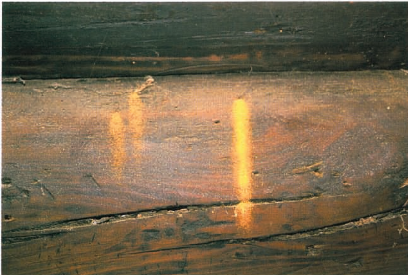
Her er det spor av stripet borebille. Ens-farget boremel har falt ut av utflyvningshullene. Billen trives best på kjølige steder med høy luftfuktighet, for eksempel kjeller, loft og andre deler av bygninger som ikke er oppvarmet. Foto: Mycoteam a.s.
