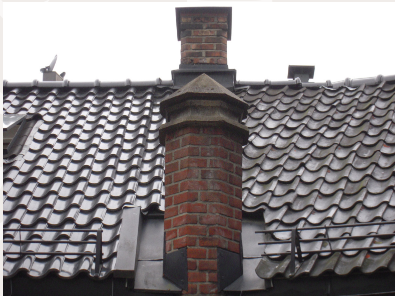
Bildet viser at det kan være stor forskjell på ny og gammel glassert taktegl, selv om de i prinsippet er av samme type, dvs enkeltkrum og uten fals. Vi ser at den nye steinen har en vesentlig kraftigere krumming, hvilket gir takflaten et annet preg. Det er derfor viktig å bevare de gamle glasserte taksteinene (som på høyre takflate).
