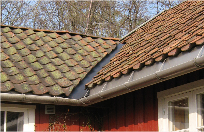
Legg merke til høydeforskjellen ved takfoten. Takflaten til venstre har tradisjonell høyde på sløyfer og lekter. Dermed blir ikke takfot beslaget så stort og dominerende. Foto: Elin Strøm © Riksantikvaren
