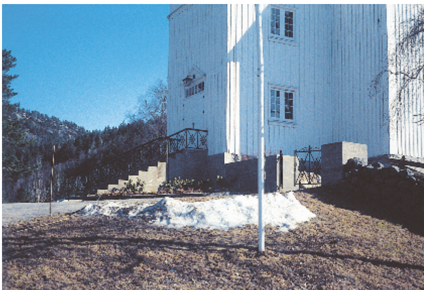
I gleden over å skape orden har betongen tatt overhånd på bekostning av det fine mureverket i naturstein som fantes her fra før. Foto: Eldal, NIKU 1996.
