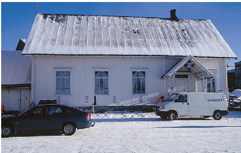
Mellombels freding kan forhindre at verdifulle bygningar blir rivne. I september 1997 gjekk Nordland fylkeskommune til mellombels freding av den over 100 år gamle fråhaldslosjebygningen i Mo i Rana. Trass i dette vedtaket blei bygningen rivne i mars 1998. Utbyggjaren blei dømd til eitt års fengsel for grovt mishald av kulturminnelova. Foto: Edvard Olav Forselv.
