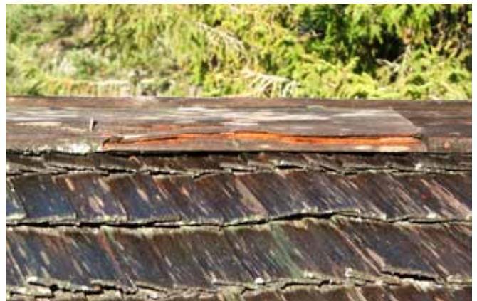
Råteskadet tak på middelalderloft i Fyresdal, Telemark. (Foto: Inge Aamlid © Riksantikvaren)
