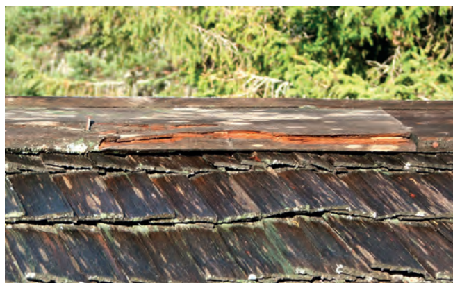
Råteskadet tak på middelalderloft i Fyresdal, Telemark.
