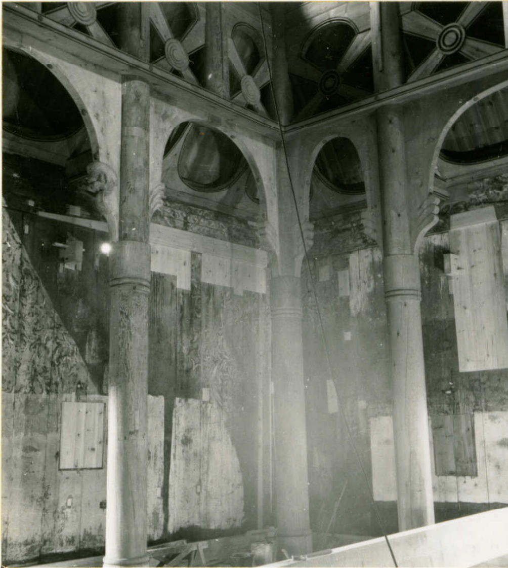
Fig. 11: Eldre gjenkabbinger og nyere innspunsinger synlige ved restaureringen i 1930-1955. Sørvestre hjørne i skip. Foto: Sæter 1954, Riksantikvarens arkiv.
