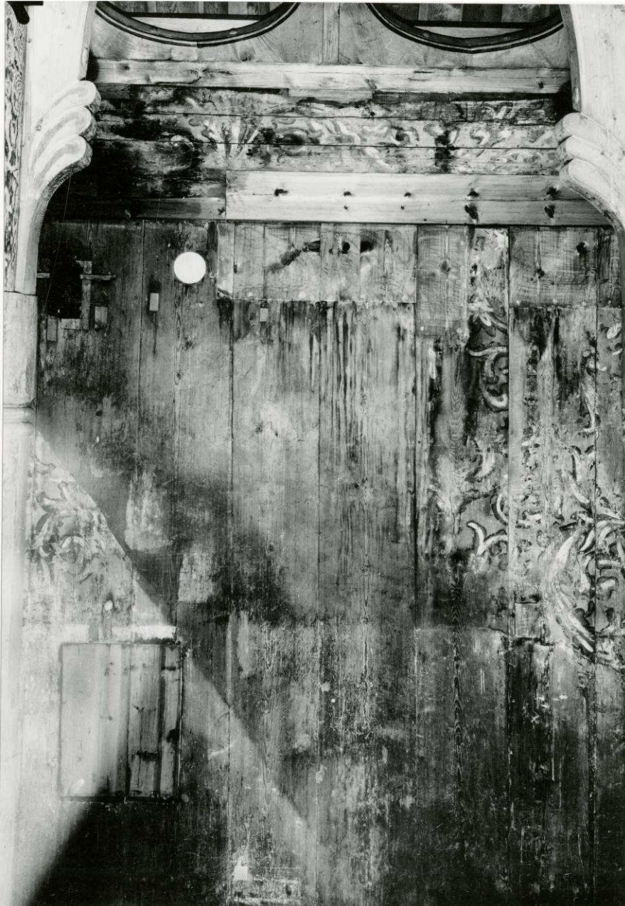
Fig. 1: Negative fargespor etter trapp på sørvegg. Trappen har gått fra gulv til stavleggje og har ikke hatt innervange. Foto: Væring, Riksantikvarens arkiv.
