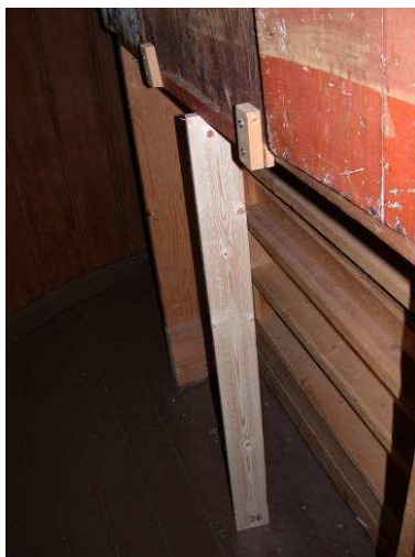
Figur 47: Altertavlen. Etter remontering. Altertavlen støttes i underkant med en planke som går ned til gulvet, og med to klosser skrudd fast til alterbord og bakvegg. Foto: Merete Winness, NIKU, 2007
