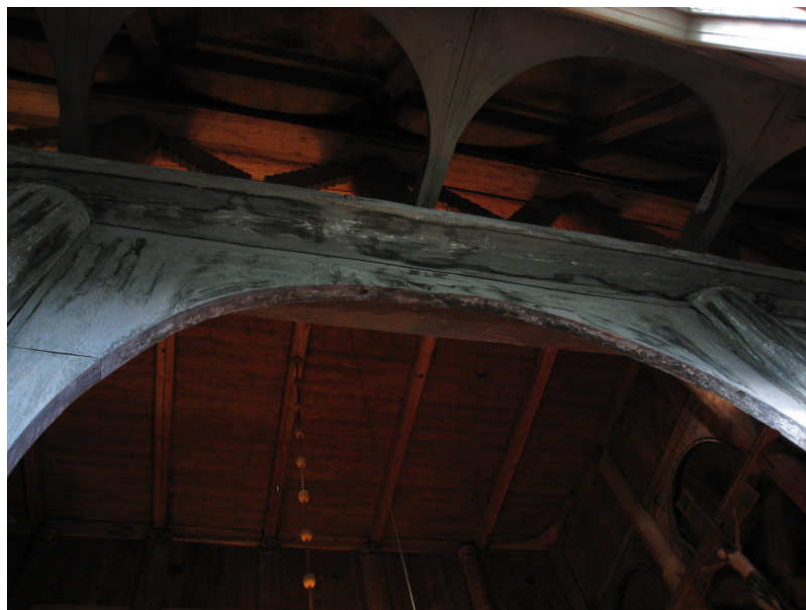
Figur 13. Innside av bueknær på sørveggen, vannskader.
